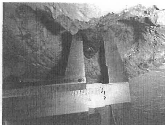
Výztuž „R“ průměru 14 mm. Mírná povrchová koroze.
