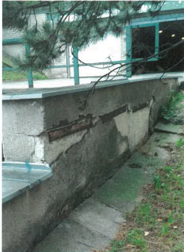
1.06 Zavlhání opěrné stěny u příjezdu
